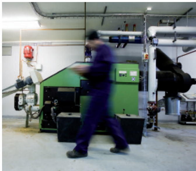
Panncentralen. Till vänster matas flisen in och till höger går rökgaserna ut.
